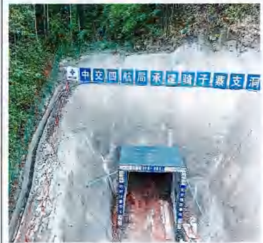
李子峡支洞洞脸截水沟
