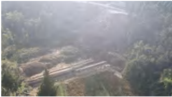
GY-3#弃渣场 (未完成挡墙)
